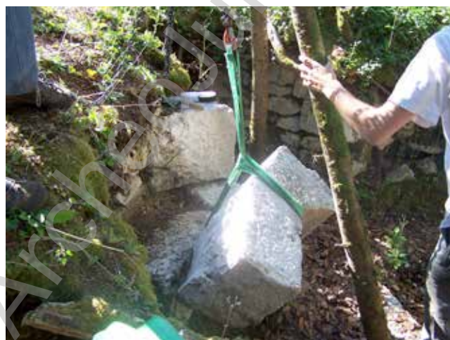
Dégagement de structures en pierre de taille et récupération de gros blocs éboulés
